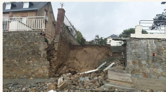
St Jean le Thomas, tempête Eleanor le 2 janvier 2018: une digue cède...
