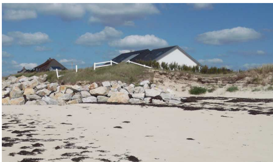
Figure 4-4 : détail de l'anse d'érosion à l'extrémité Sud de la protection.
